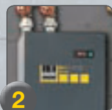
2 Подготовка сжатого воздуха
